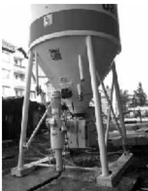
3.24 Kompletná strojná zostava – transportné silo + silová miešacia stanica SMP FE
